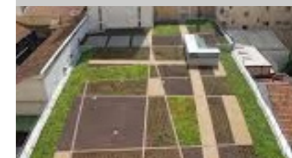
Fig. 4. Cubierta vegetada en el supermercado Mercadona de la C/ Bravo Murillo, Madrid.
