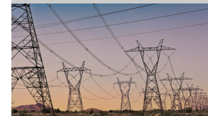
Fig. 12. Líneas de alta tensión.
