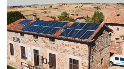
Fig. 10. Placas fotovoltaicas en cubierta.
