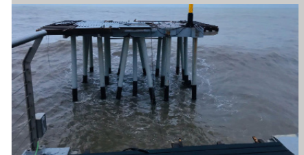
Fig. 8. "Gloria" derrumba el Pont del Petrolí.
