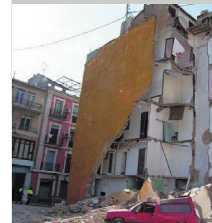
Fig. 7. Estado de la finca de la calle Sant Mateu, tras el derrumbe de una vivienda.
