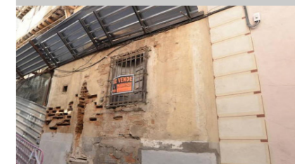
Fig. 10. Edificio en ruinas en la cuesta de San Justo.
