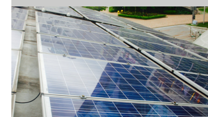
Fig. 4. Fotografía de las placas solares en el edificio.
