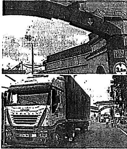
Daños ocasionados en la estructura del arco (imagen superior) por un camión arrollado (imagen inferior). JORDI MARTE
