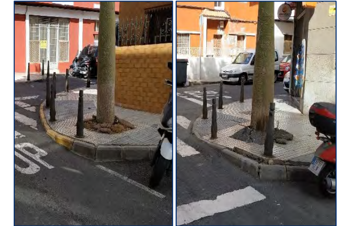
Mal estado de los alcorques en calle Don Pío Coronado y adyacentes debido al crecimiento excesivo de los árboles que albergan.
