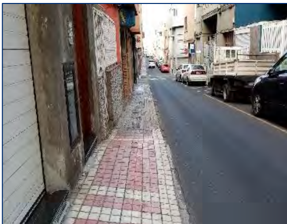
En la calle Agustina de Aragón se observan hasta tres tipos de pavimento en aceras en el mismo punto.
