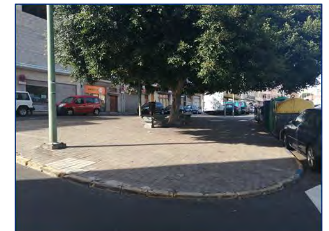
Aspecto degradado de la plazoleta situada en el encuentro de las calles Voluntad con Mariucha: Mobiliario y parterre descuidado y pavimento en mal estado.
