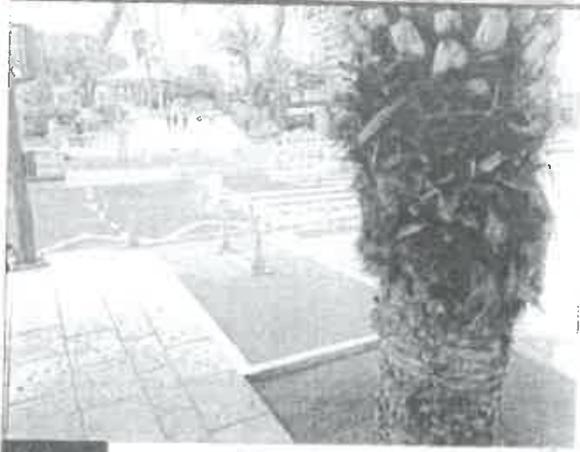
Así no se acepta el carril bici. El servicio de Urbanismo del Ayuntamiento ha comunicado a la Autoridad Portuaria que el carril bici que ejecuta junto al centro El Muelle y que choca con una palmera «tiene defectos y se niega a receptorarlo si no se corrigen estos errores», explicó desde el Consistorio capitalino.
