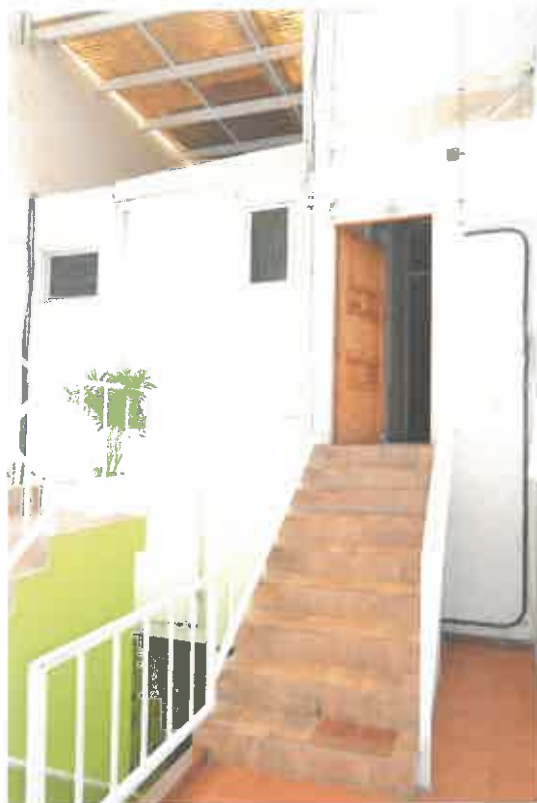
Escalera a segundo nivel vivienda. (nivel forjado planta alta original hacia c/ Triana)
