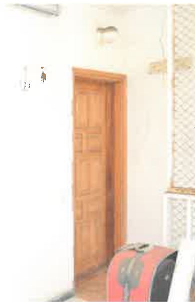
Tercer nivel vivienda. (Crujiás interiores)
