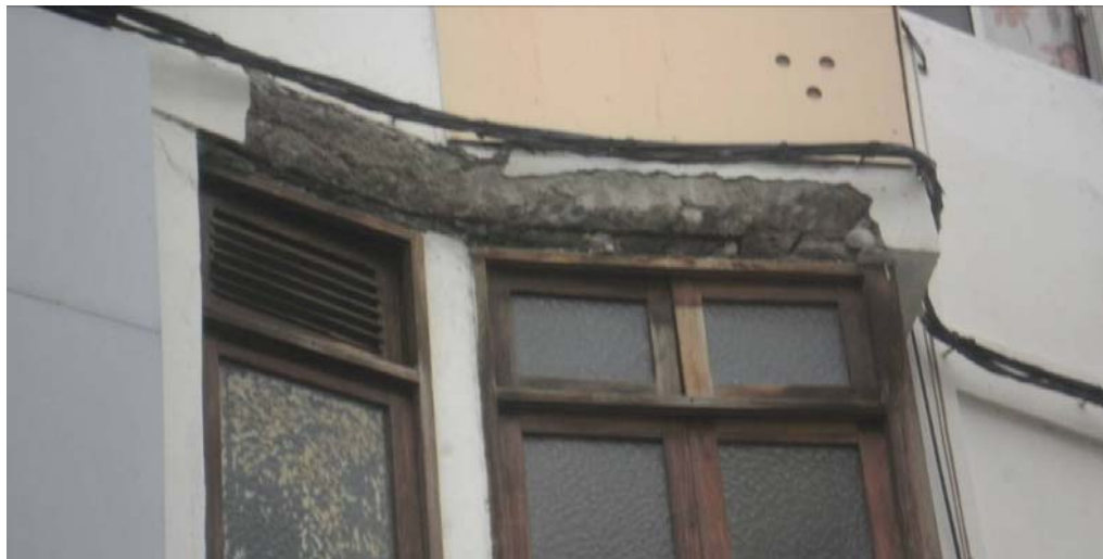
Detalle del deterioro en fachada principal.
