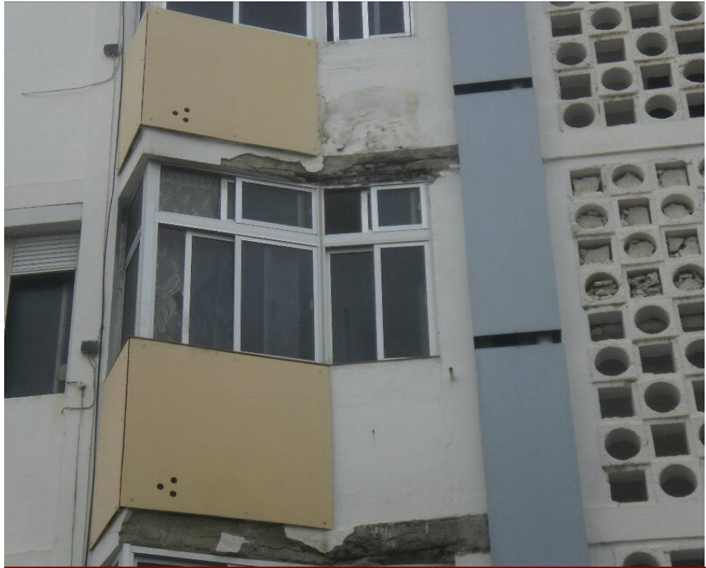
Detalle del deterioro en fachada principal.
