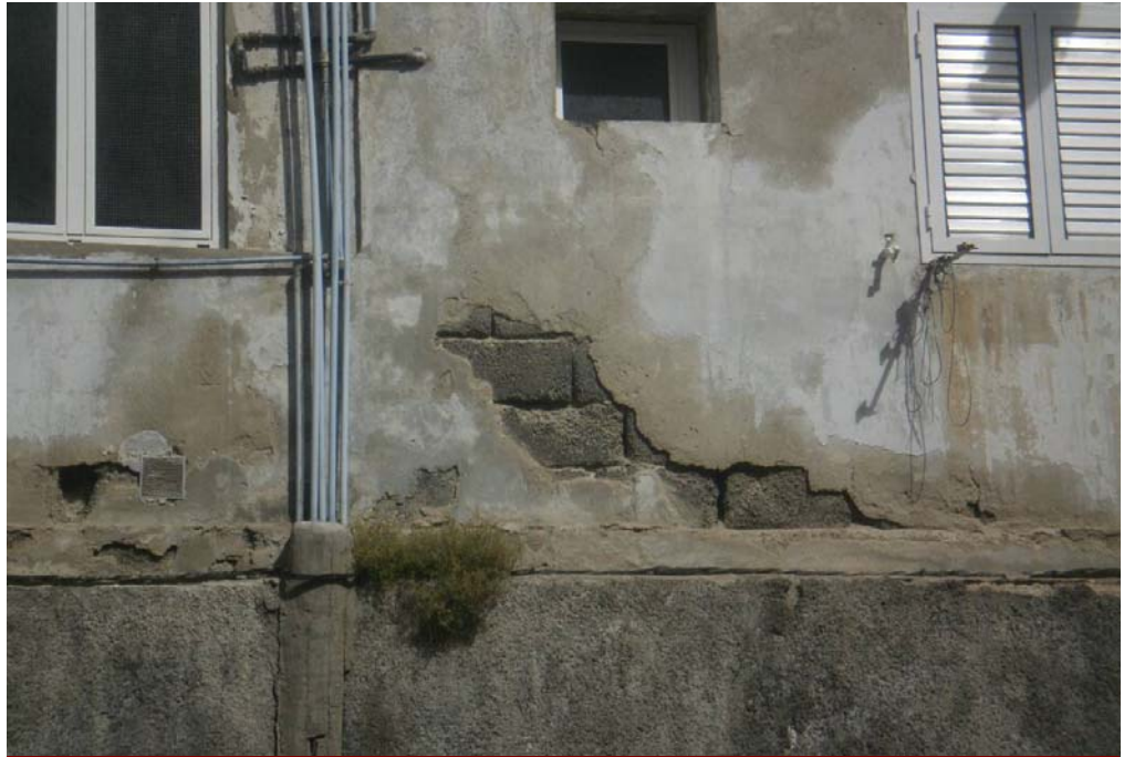
Detalle del deterioro en fachada trasera.
