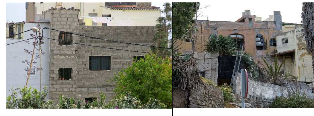
Fotográfico 17 y 18. Inadecuación de fachadas
