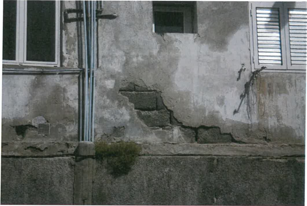
Detalle del deterioro en fachada trasera.
