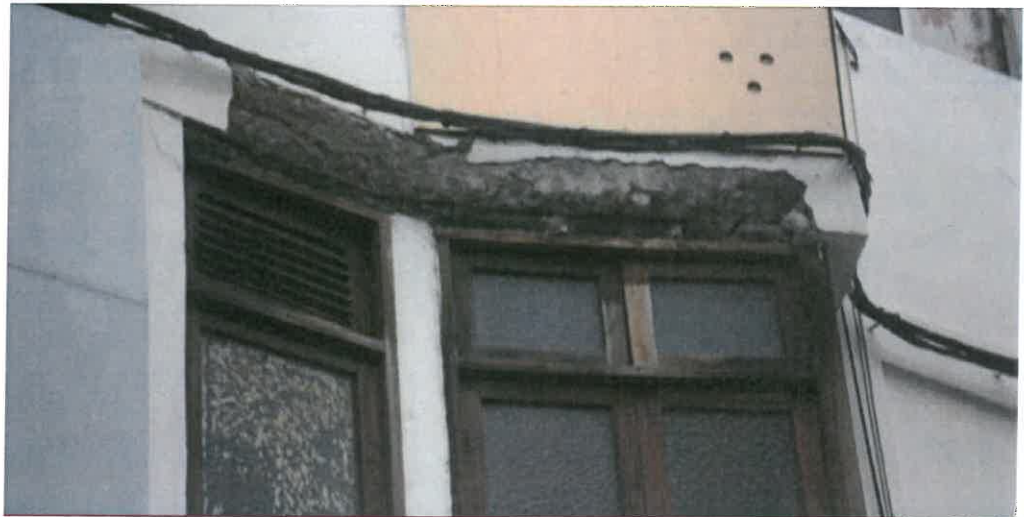
Detalle del deterioro en fachada principal.
