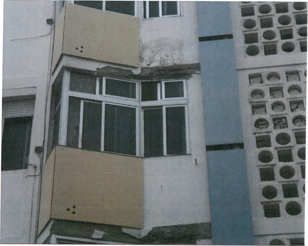
Detalle del deterioro en fachada principal.
