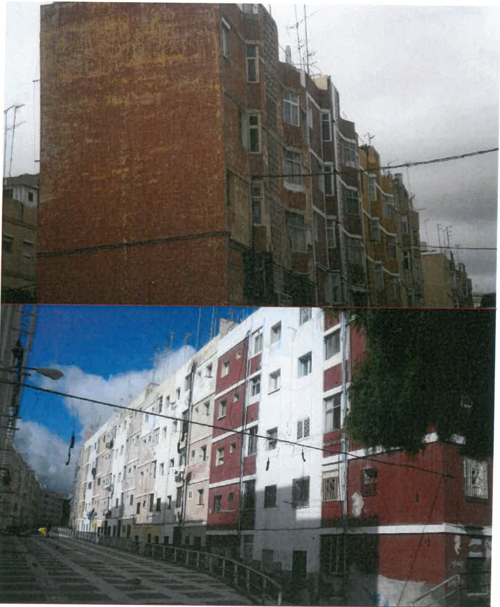
Deterioro en fachada principal (foto superior) y en fachada trasera (foto inferior).
