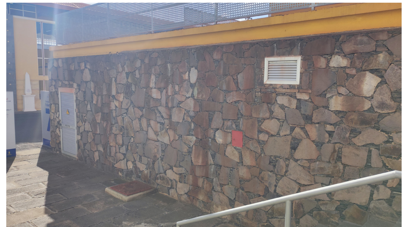
Zona de instalaciones existente cercana al Pabellón 7. Fuente: LPA Studio.
