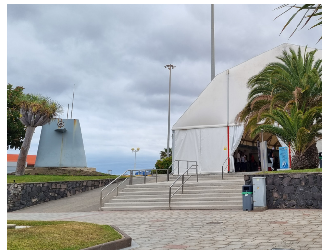
Escaleras y rampas no ajustadas a la normativa sectorial. Fuente: LPA Studio.
