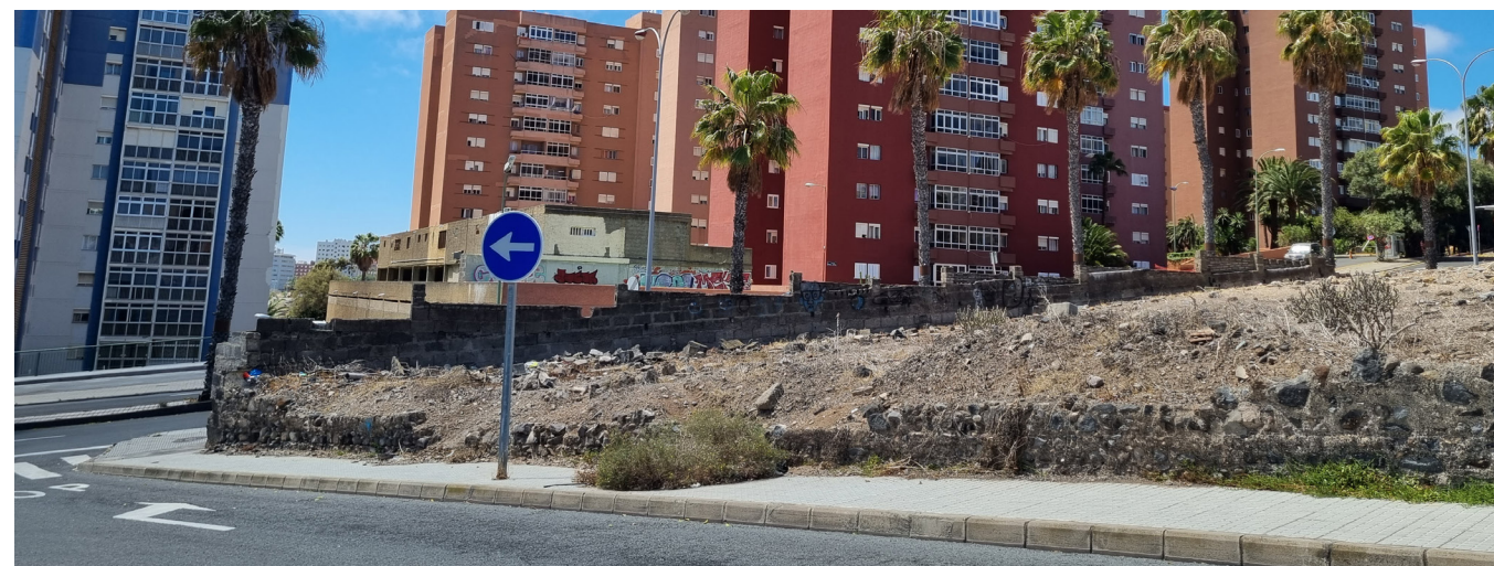
Muro parcialmente derruido en la zona sur del ámbito. Fuente: LPA Studio.
