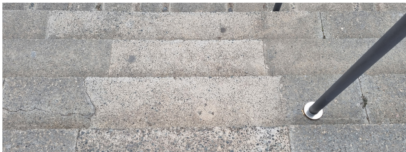
Escalera deteriorada del interior del Recinto Ferial. Fuente: LPA Studio.
