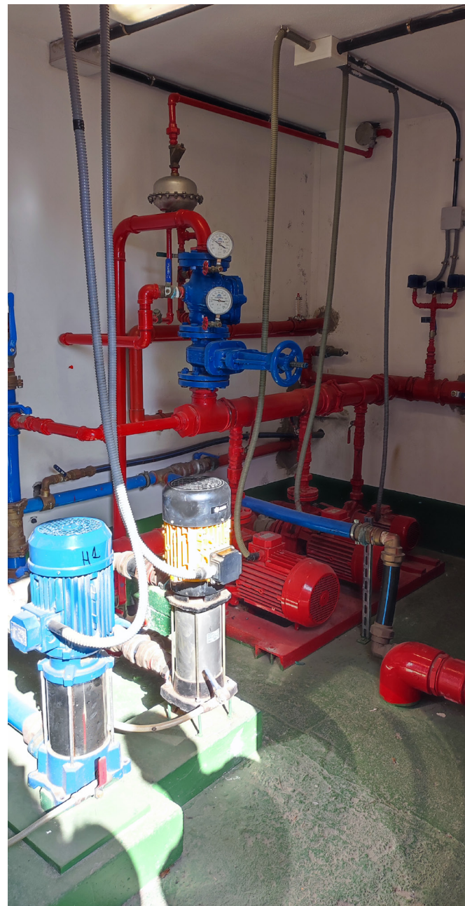
Instalaciones existentes en el Recinto Ferial. Fuente: LPA Studio.
